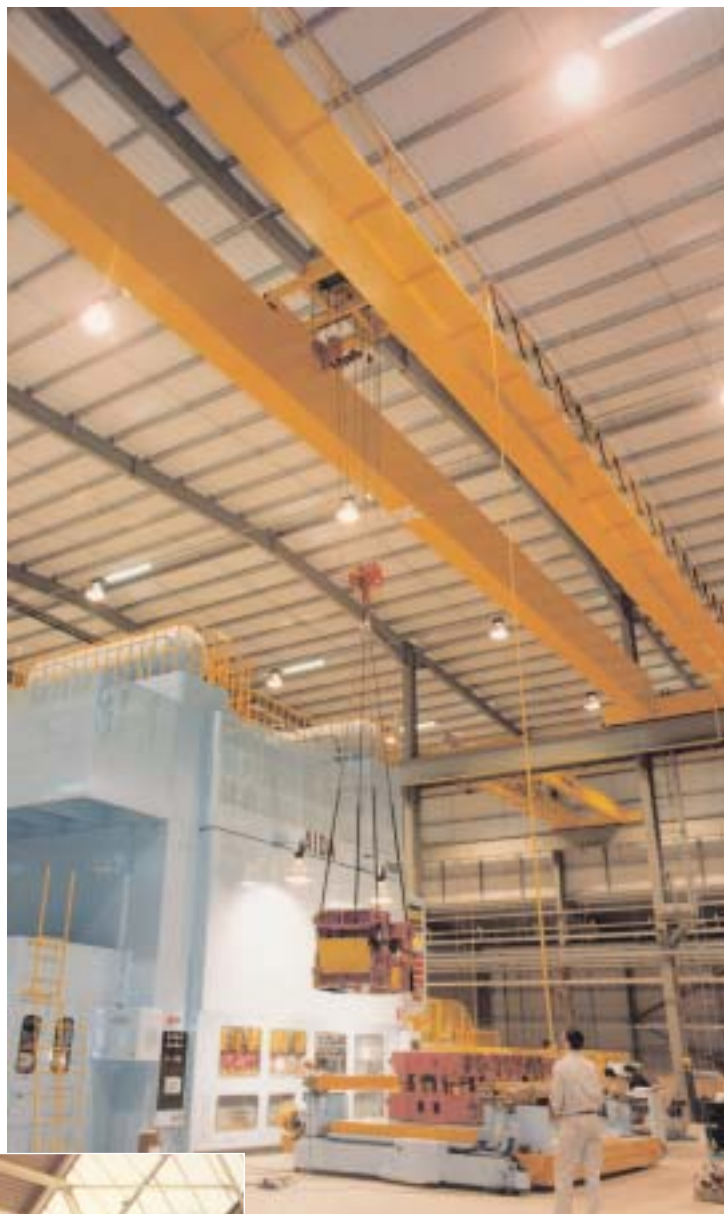
20t Die Handling Crane Stadco Taco
